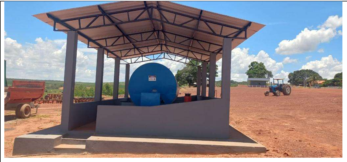
Estrutura para abastecimento de maquinários - Fazenda Alvorada do Norte
